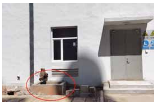
硫酸罐事故池
