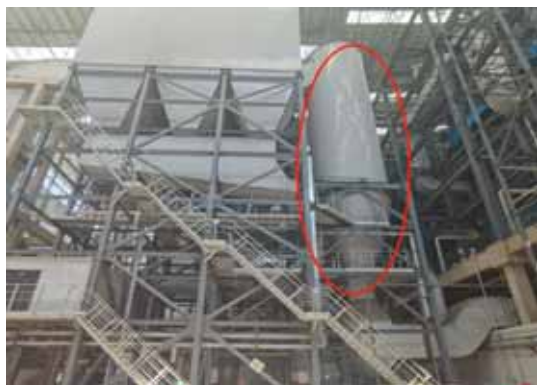
炉外脱硫塔及布袋除尘器
