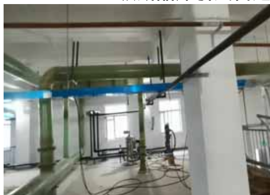
渗滤液处理站引风管道
