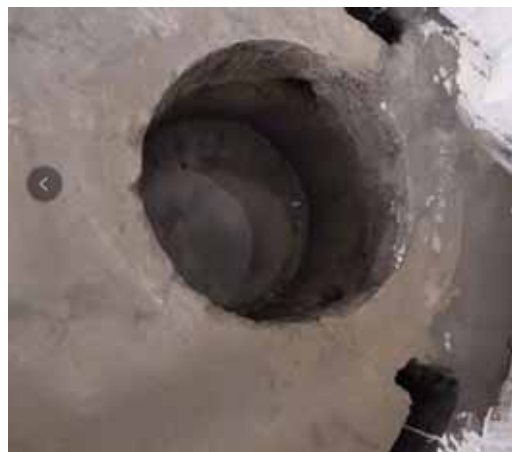
库内导水沟、集液池
