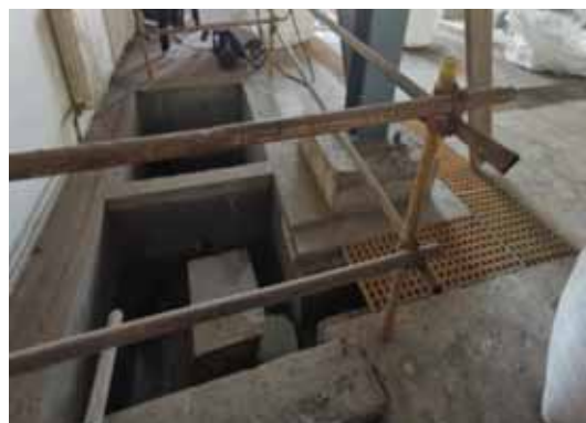
飞灰稳定化车间集水池
