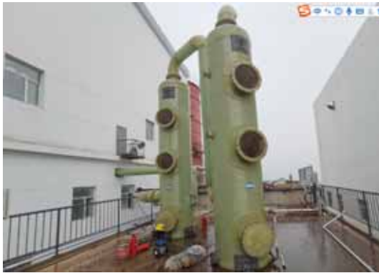
渗滤液站应急除臭装置
