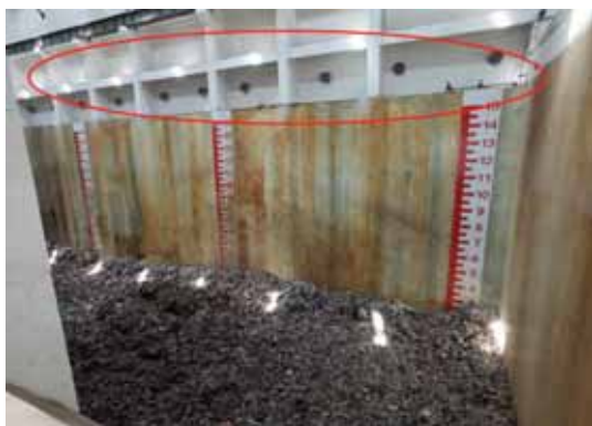
垃圾原生库引风管道
