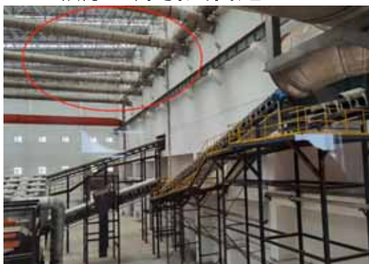
垃圾分选车间引风管道
