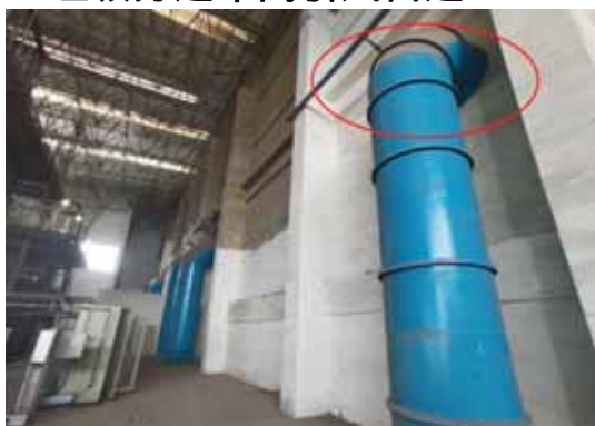
二次风机接入口
