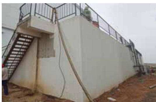
调节池（兼事故池）
