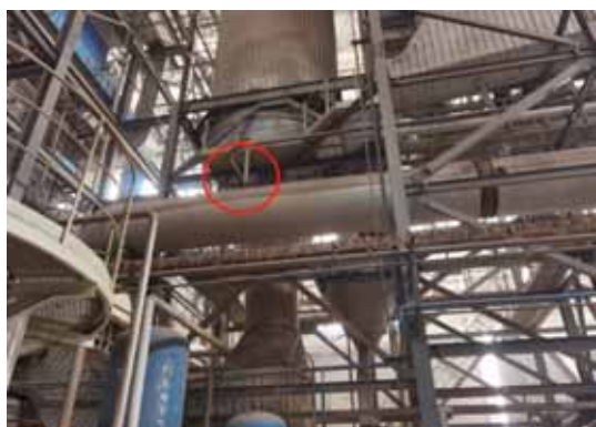
消石灰喷射管线
