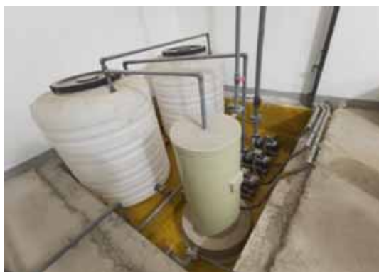
渗滤液处理站盐酸罐
