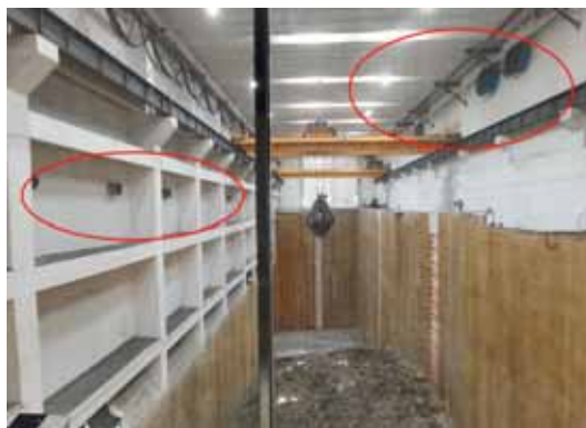
垃圾成品库引风管道
