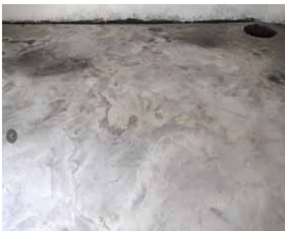
库内导水沟、集液池
