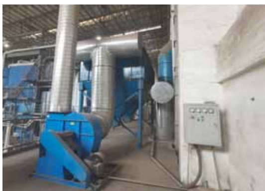
输煤皮带布袋除尘器
