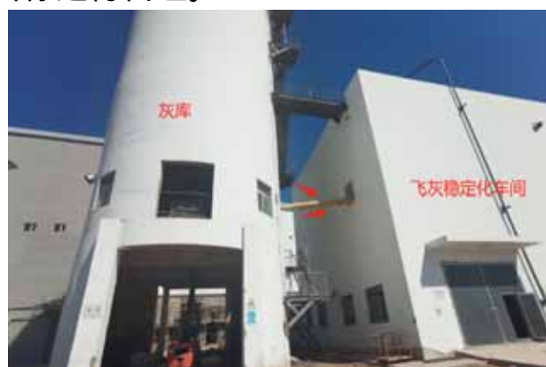
灰库及输灰管线
