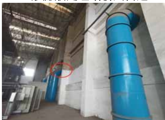
一次风机接入口
