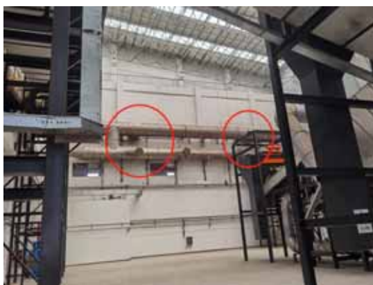
垃圾分选车间引风应急管道接口
