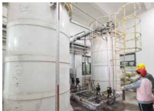
螯合剂罐及稀释罐
