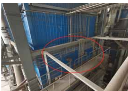
锅炉顶部氨水喷射位置
