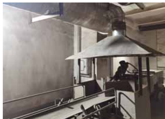
输煤皮带集气系统
