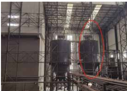
消石灰仓顶布袋除尘器
