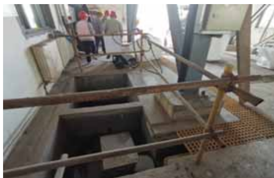
飞灰稳定化车间事故池
