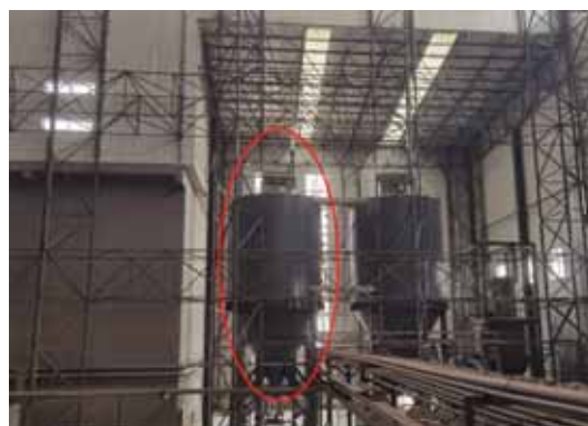
石灰石仓顶布袋除尘器
