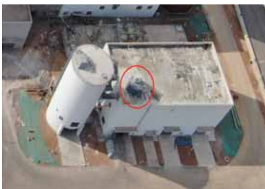
水泥仓顶布袋除尘器
