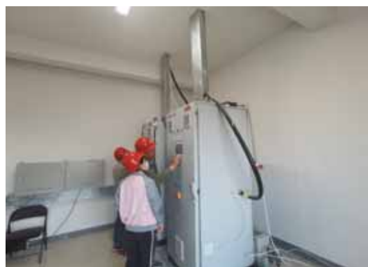
1、2号焚烧炉烟气出口在线监测
